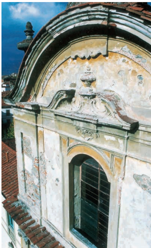
Sommità della facciata principale, prima dell'intervento, segnata da un diffuso degrado.
