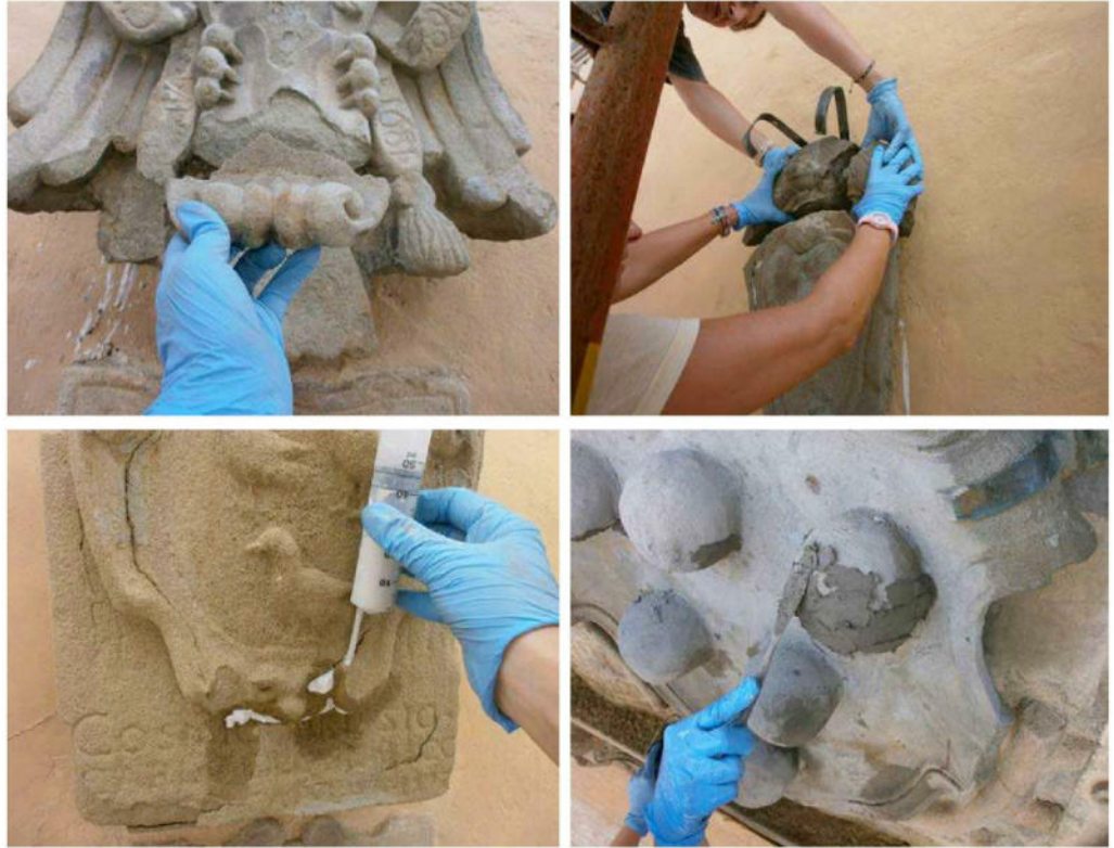
Immagini durante alcune fasi di consolidamento e restauro degli elementi in pietra.
