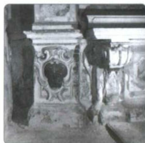
8. Modellato e stucchi dorati della sommità degli altari laterali. 9. Il degrado prima dell'intervento di restauro.
